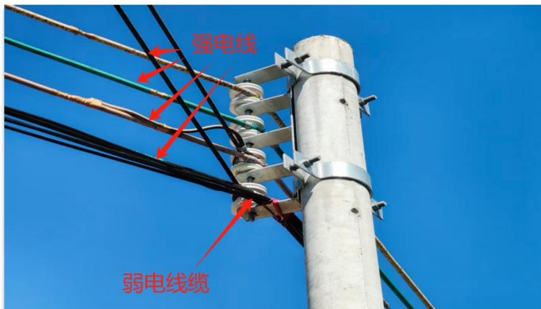
弱电线缆直接搭挂强电路由，存在严重安全隐患
